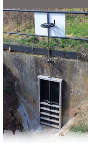
Vanne du bassin des Cochevis
